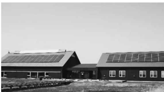
屋根置き自家消費型の太陽光発電設備
